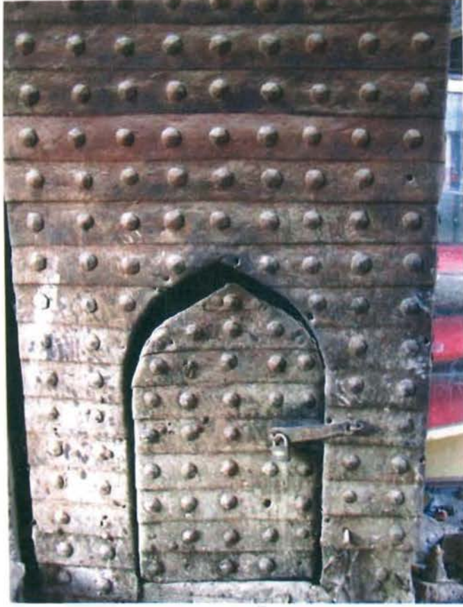
Fotoğraf 9- Hanın korozyona uğramış kapısından detay
