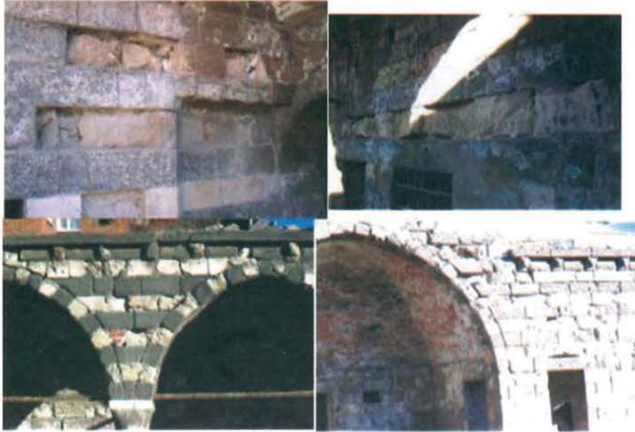
Fotoğraf 10- Hanın inşa malzemesindeki tahribatlardan detay
