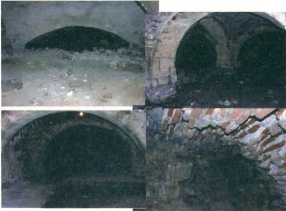
Fotoğraf 8- Hanın restorasyon öncesi örtü sistemindeki tahribatlar
