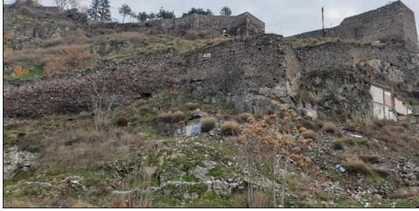
Fotoğraf 35: Surların onarım öncesi durumu (Ahmet SANSAR, 2021).
