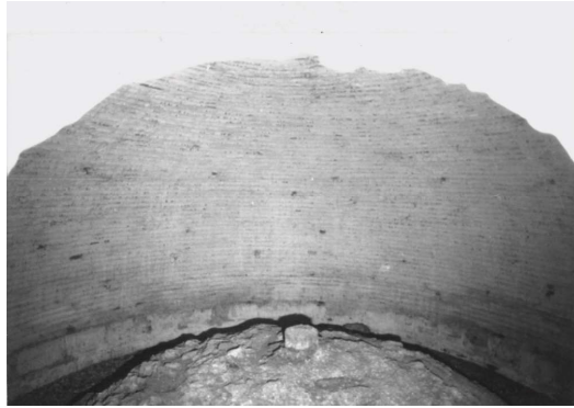
Şekil 6: Şehzade Camii köşelerinde buluna çift cidarlı kubbenin iç görünüşü. (Aras Neftçi, Mimar Sinan Dönemi Dini Yapılarda Kubbe Örtü Sistemleri, Yayınlanmamış Yüksek Lisans Tezi, Yıldız Üni., 1991, s.8).
